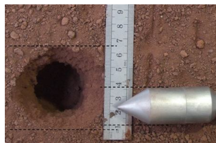
图13 地基表面土体变形
